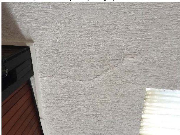
c) pukotine u zidanom zidu
