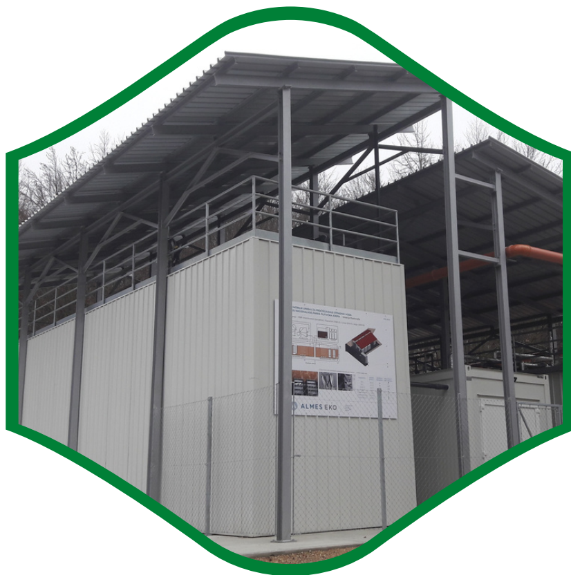
Uređaj za pročišćavanje otpadnih voda
